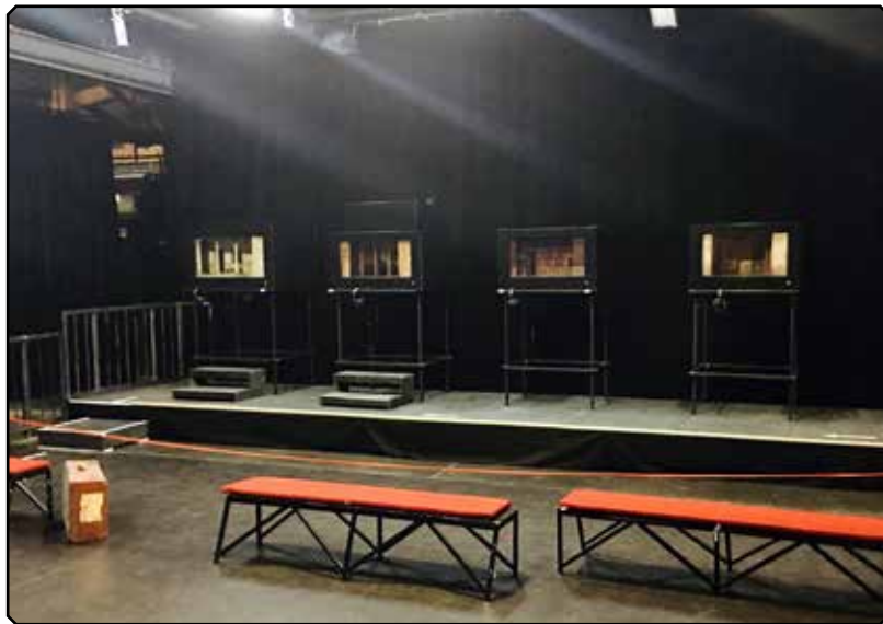
Installation au Glob Théâtre (33) - avant la mise au noir de la salle
